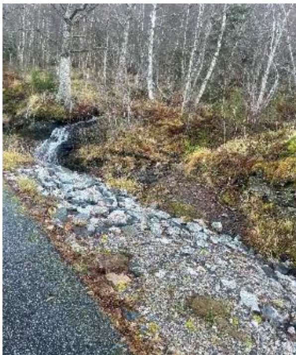
Bilete 5.3-3 Grøft langs løypetrasé. Dei fleste grøftene er i god stand. Foto: Norconsult
